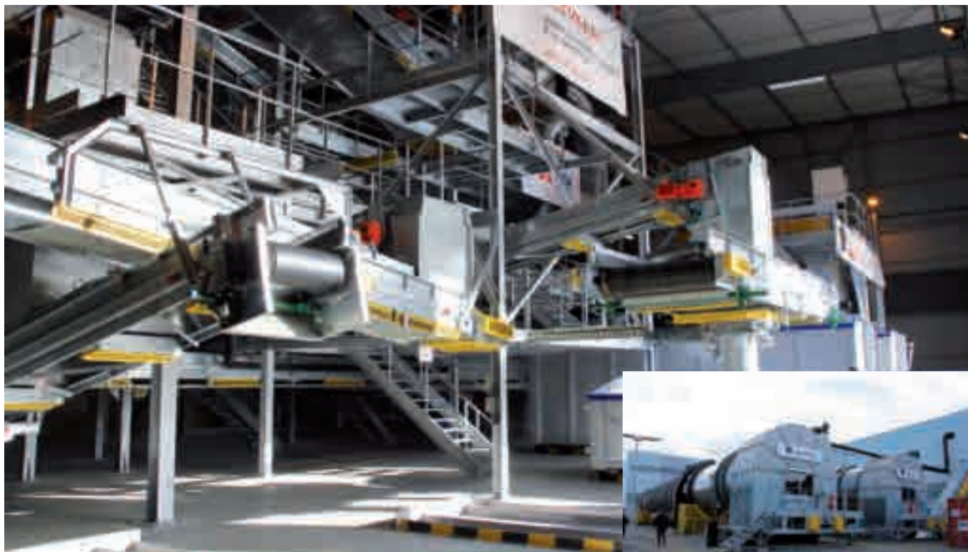
C'est la société Alfyma qui a conçu et fourni le process de tri et de maturation des ordures ménagères résiduelles.
